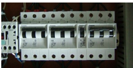
Sicherungsautomaten bei Geräten mit externem Schaltschrank
